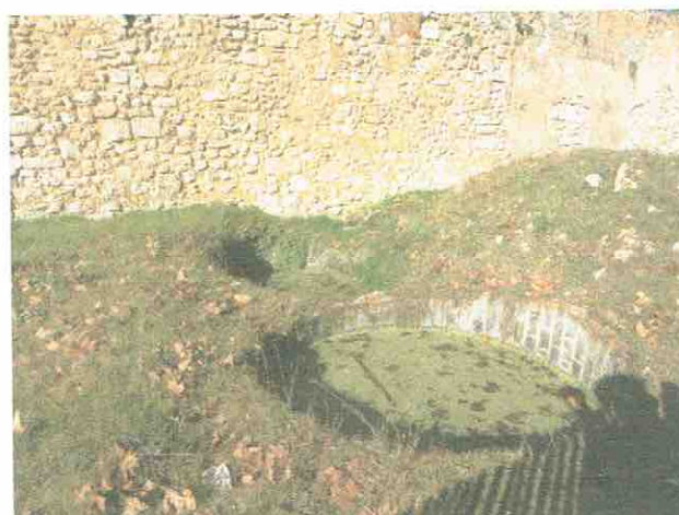
Des anciens puits à sécurisés
